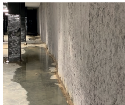
Fot. 8. Widok odształceń ściany szczelinowej
