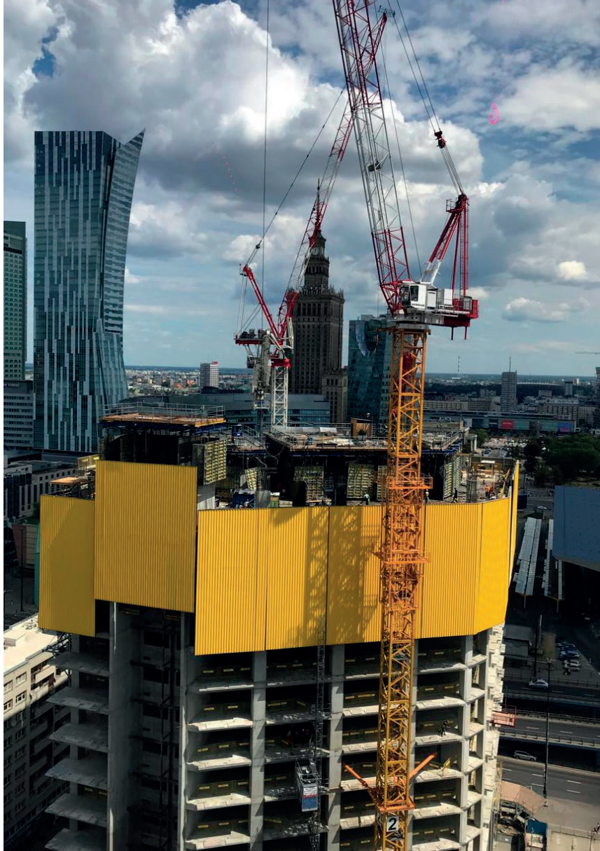
Fot. 6. Specjalne dźwigi, które posłużą po wydłużeniu do montażu iglicy oraz widok deskowania firmy Doka. Wznoszenie tak wysokiego budynku wymaga właściwej koordynacji pracy na budowie oraz zastosowania specjalistycznych deskowań
