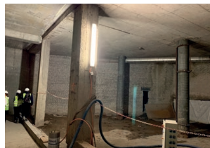
Fot. 9. Miejsce połączenia Kompleksu Varso z pasażami Dworca Centralnego, widoczna różnica w technologii wykonywania elementów żelbetowych w latach 70. XX w i obecnie
